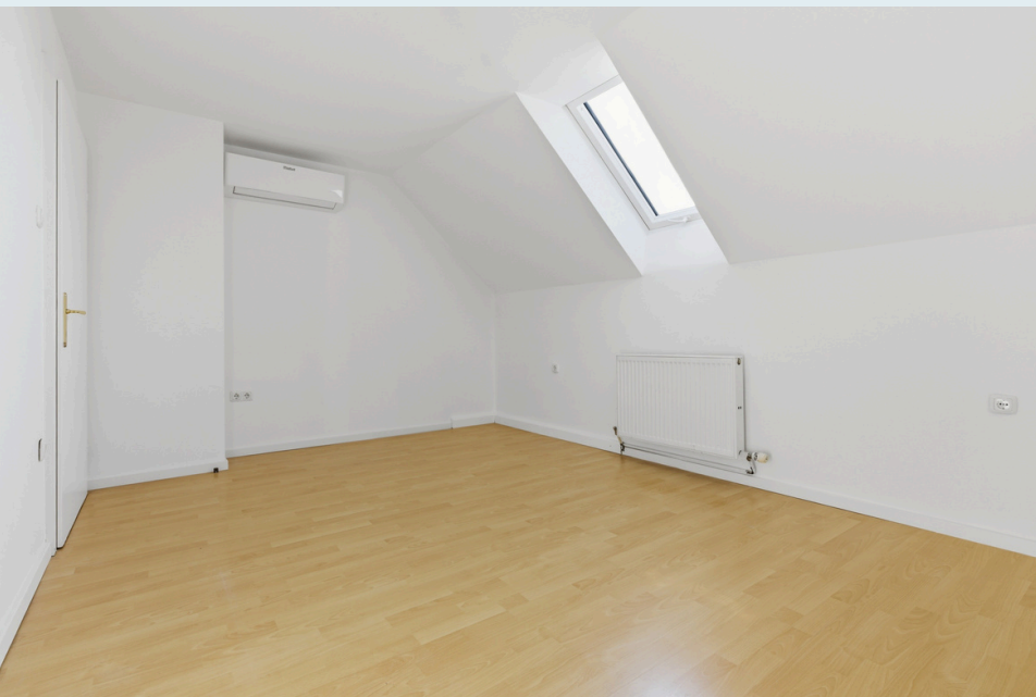
Schlafzimmer B3 mit Klimaanlage
