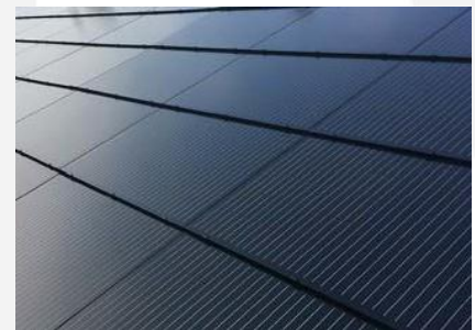
PV-Anlage am Dach Symbolfoto
