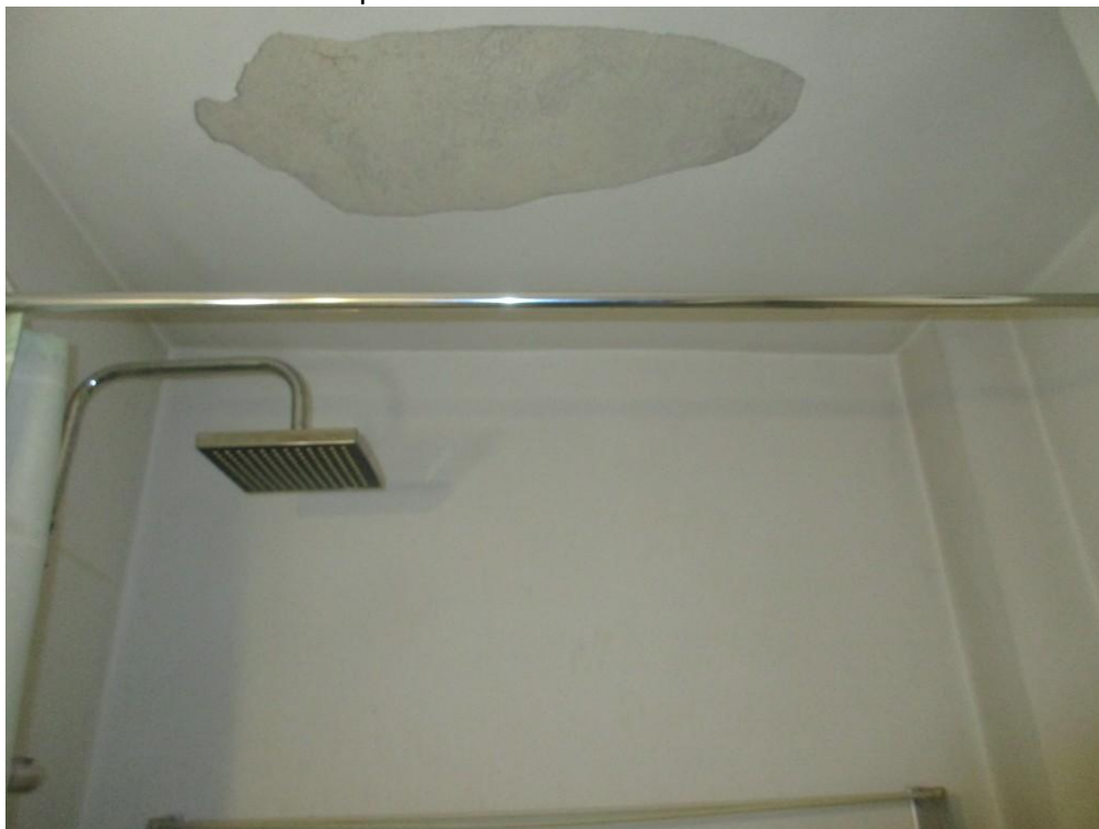
Schadhafte Stelle im Badplafond:
