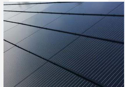
PV-Anlage am Dach Symbolfoto
